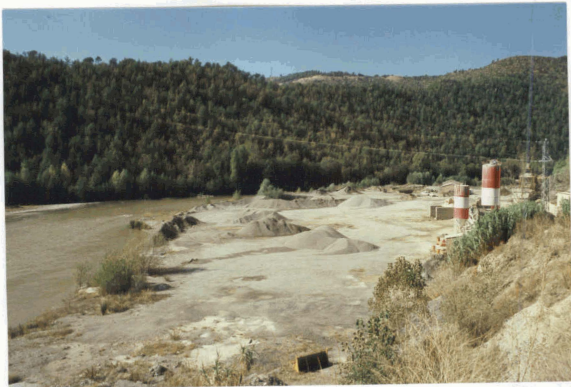
Fotografía 9.- Socavación de pie de la plaza de acopios. Se produjo el arrastre de instalaciones y acopios por avenida del Segre en 1982.
