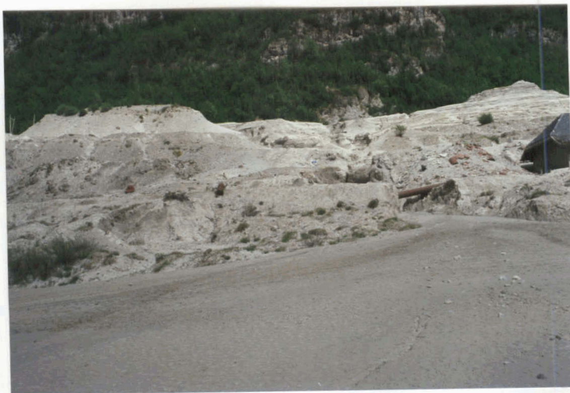
Fotografía 6.- Balsa de Bono (estructura 32-09-7-51). Detalle de los fenómenos erosivos que afectan a la estructura.
